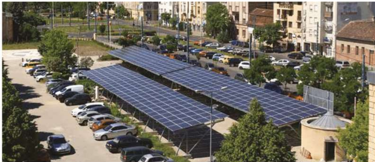
Budapest, Uzsoki utca - 424 kWp
