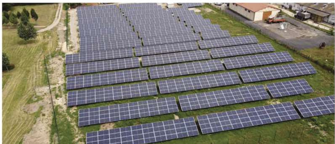
Óhíd(Saját erőmű) - 500 kWp
